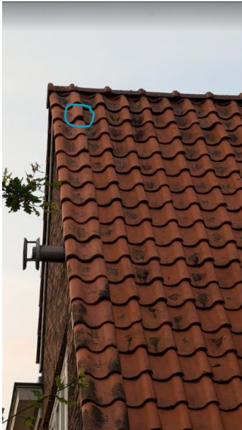
Figuur 6 invliegopening kierende dakpan Adema van Scheltemastraat
